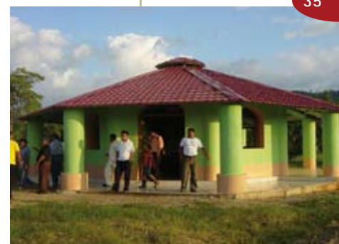
7. Construcción de la primera aula del proyecto escolar en la comunidad de Diamante de Sión, departamento de Atlántida, Honduras.
